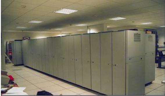
Figure 3: xemple d'une Centrale Téléphonique ancienne génération
